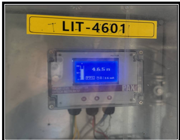
* 신규 수위계 설치 완료 *
